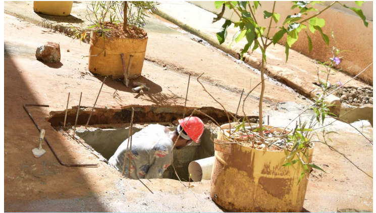
Realización de trabajos para resolver problema de drenaje en el área del antiguo Marión.
